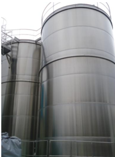
Figure 26 : Cuve de stockage
