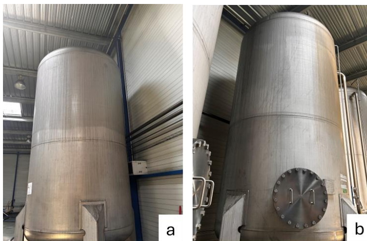
Figure 24 : Tour d'oxydation (a) et tour de filtration sur sable (b)
