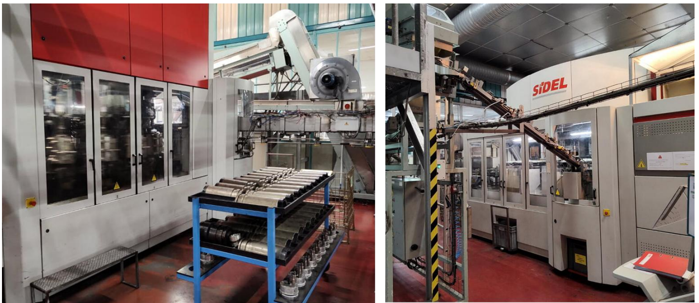
Figure 30 : Photos de la souffleuse de l'unité de production existante
