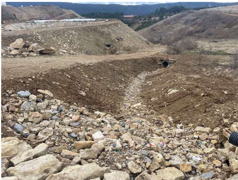
Figure 3 : Busage réhabilité du Valat de Rivemale situé en limite est du projet -Source : EMC 48, 25/03/2025
