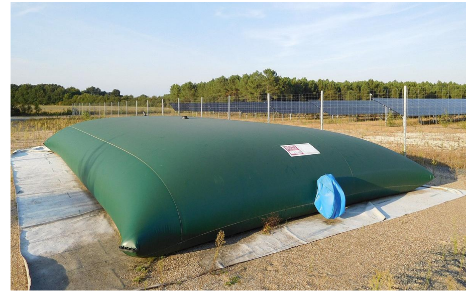
Figure 45 : Photo d'une bâche incendie
