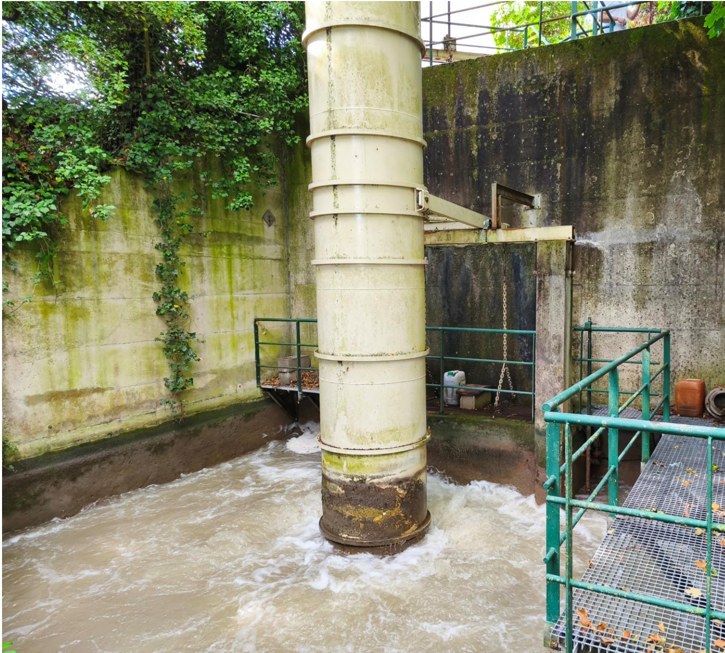
Bassin et vanne cylindrique – 21 juillet 2025
