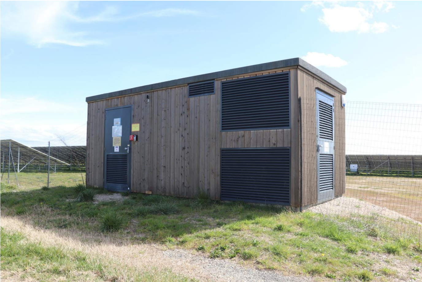
Figure 3 : Exemple de poste technique
