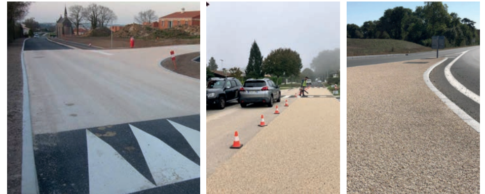
Résine gravillonnée // résine beige avec granulats sur enrobé
