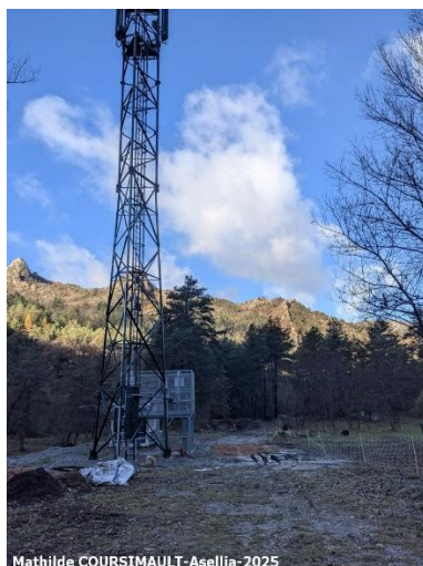
Sols piétinés et tassés par les travaux liés à l'antenne
