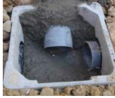
Regard de collecte des eaux grises
