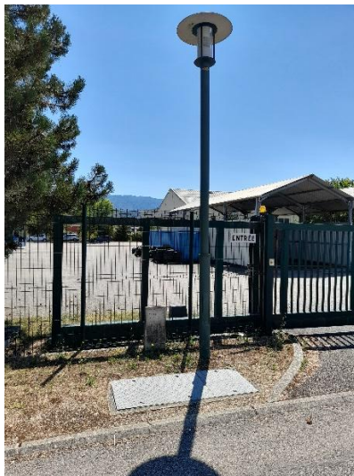
Réseau de télécommunication présent rue de l'Industrie
