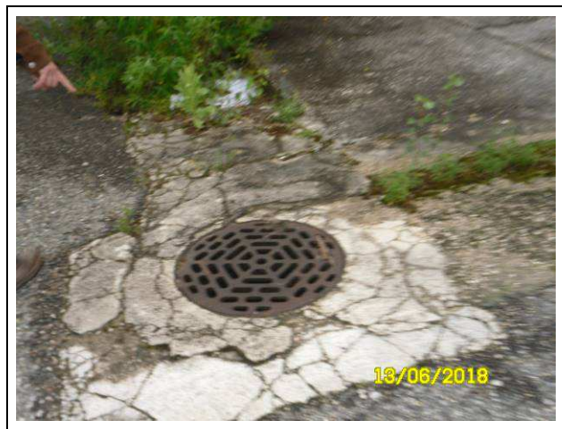
Vue d'une grille d'évacuation des eaux pluviales du site.
