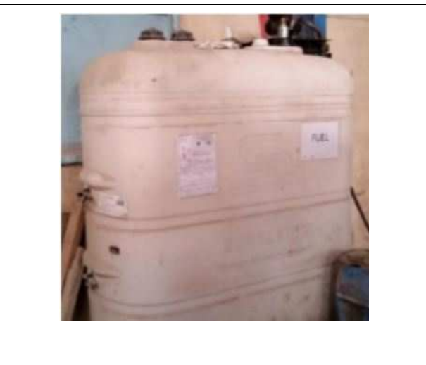
Vue de la cuve aérienne de fioul.
