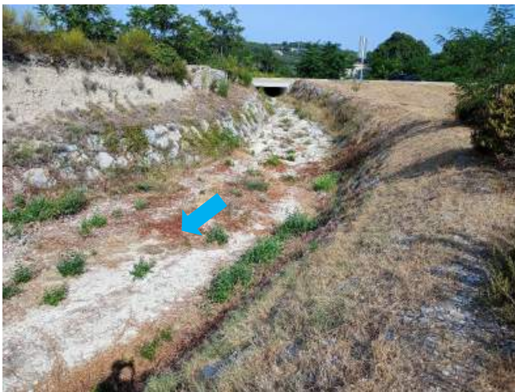
Photo 4 : Ravin du Ruinas à l'aval de la RD94 (depuis la rive gauche)
