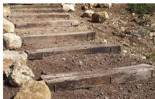
Image d'illustration de traverses bois non fondées pour l'escalier
