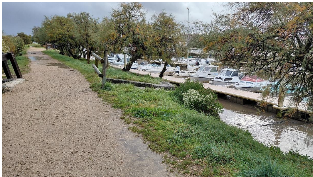
Figure 4 Erosion forte des berges du port d'Audenge
