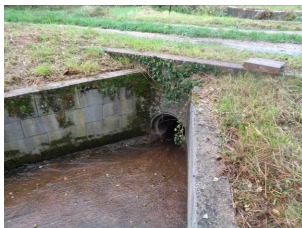
Vue des buses Ø 500 en aval de la surverse
