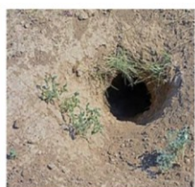
Cavités du sol
