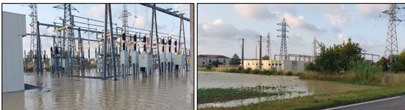
Figure 21 : Photographies du poste source de Bruch inondé (Source : ENEDIS)
