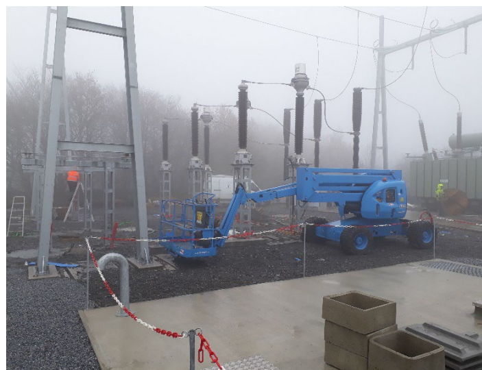
Mise en place des différents équipements HTB
