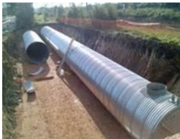
Canalisations de gros diamètre
