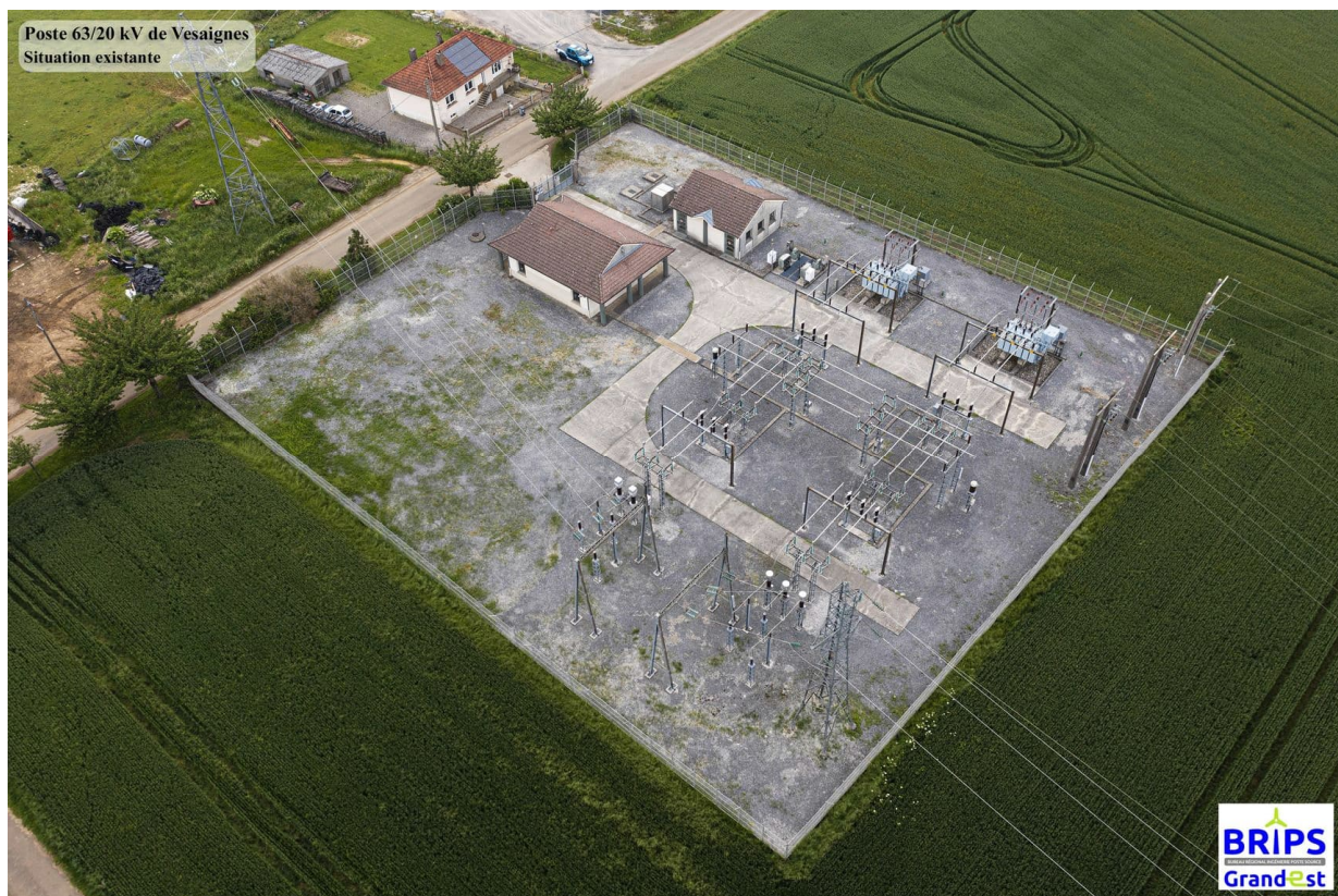
Figure 9 : Poste source de Vesaignes-sous-Lafauche : situation existante (source : BRIPS GE)
