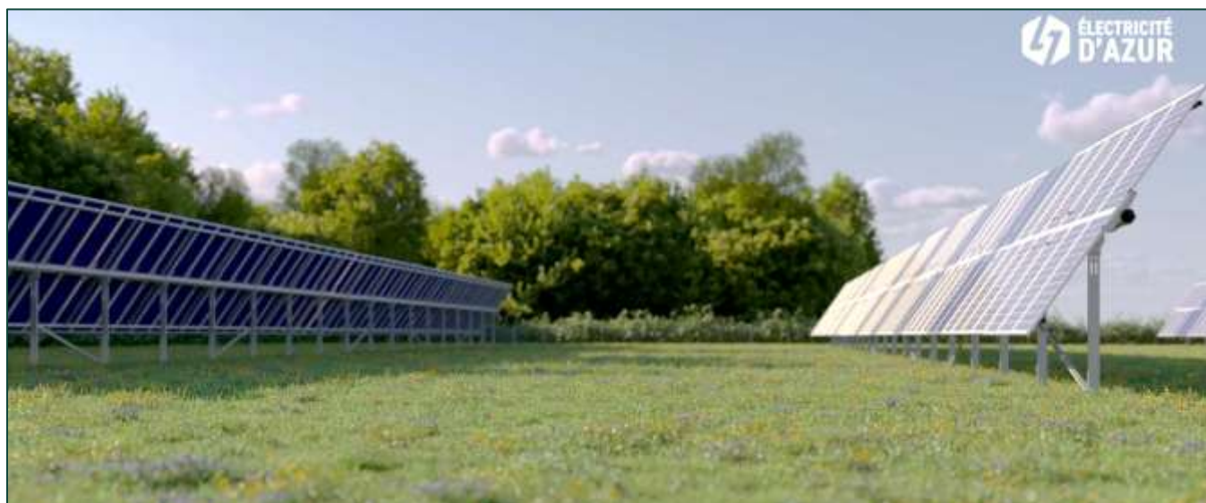
Figure 6 : Trackers (Source : Electricité d'Azur)
