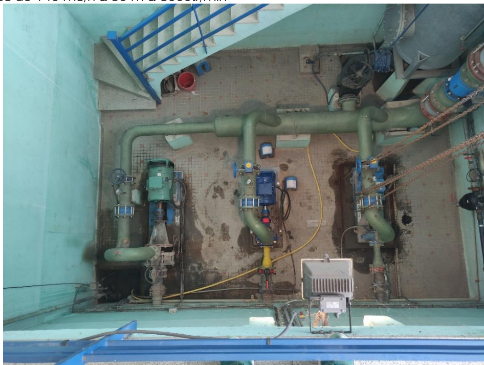
FIGURE 5: VUE DE LA STATION DE SURPRESSION LOGIS DE BERRE
