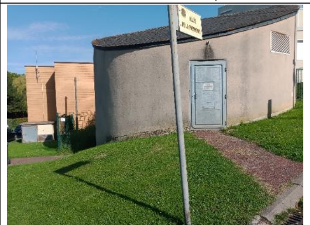
Vue des transformateurs à l'Est
