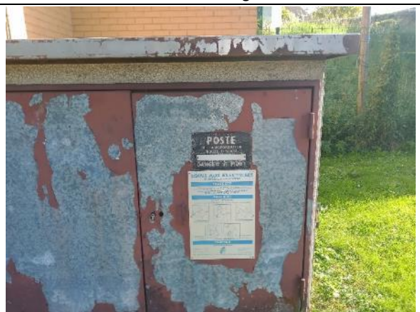
Vue des transformateurs à l'Est
