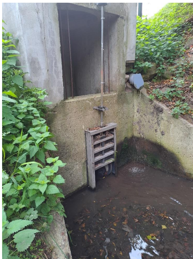
Figure 20 : Photographie – Exutoire du Bassin (vanne de sectionnement)
