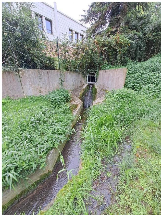
Figure 21 : Photographie - Arrivée principale du bassin (Nord) depuis le réseau EP/Ru
