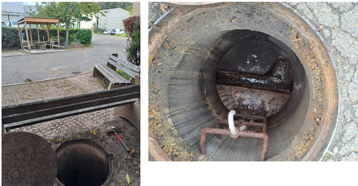
Figure 27 : Regard n°2 - réseau EP Sud
