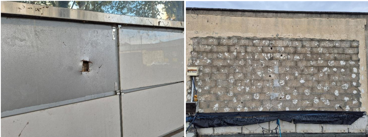
Figure 26 : Anfractuosité sur la façade du bâtiment (à gauche), anfractuosités sur un muret présent sur le toit (à droite) ©EODD, 2025
