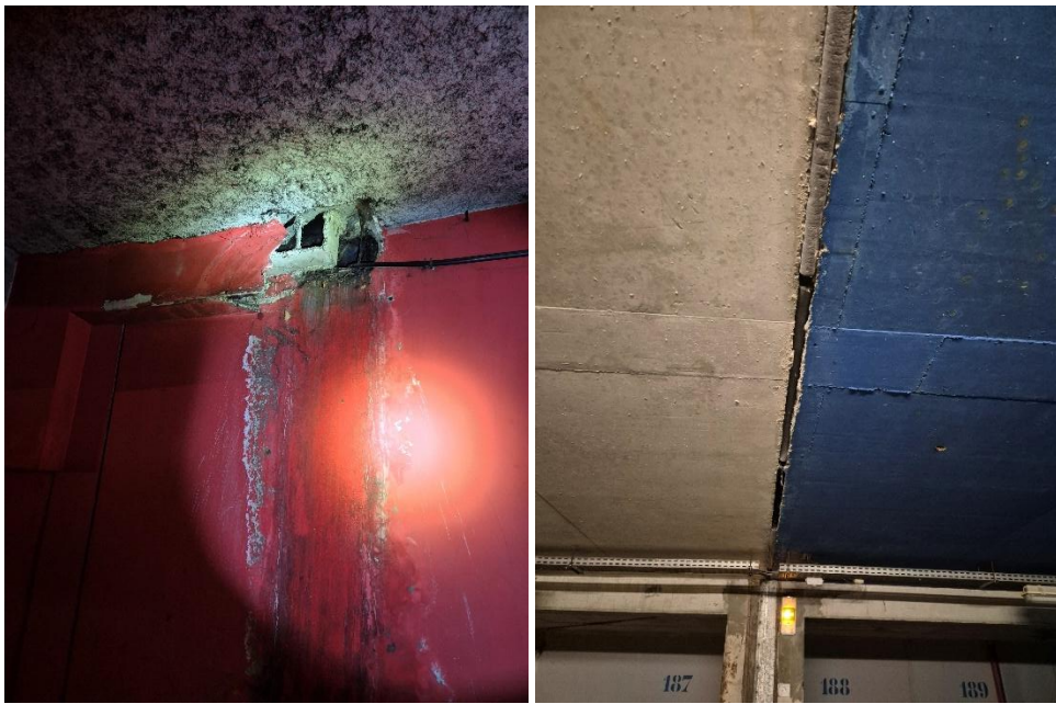
Figure 25 : Anfractuosités dans les sous-sols du bâtiment ©EODD, 2025
