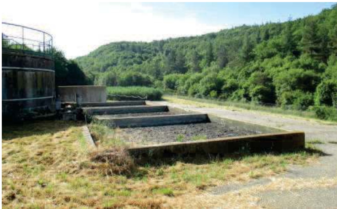
Vue sur la station d'épuration – ECOTER 2025
