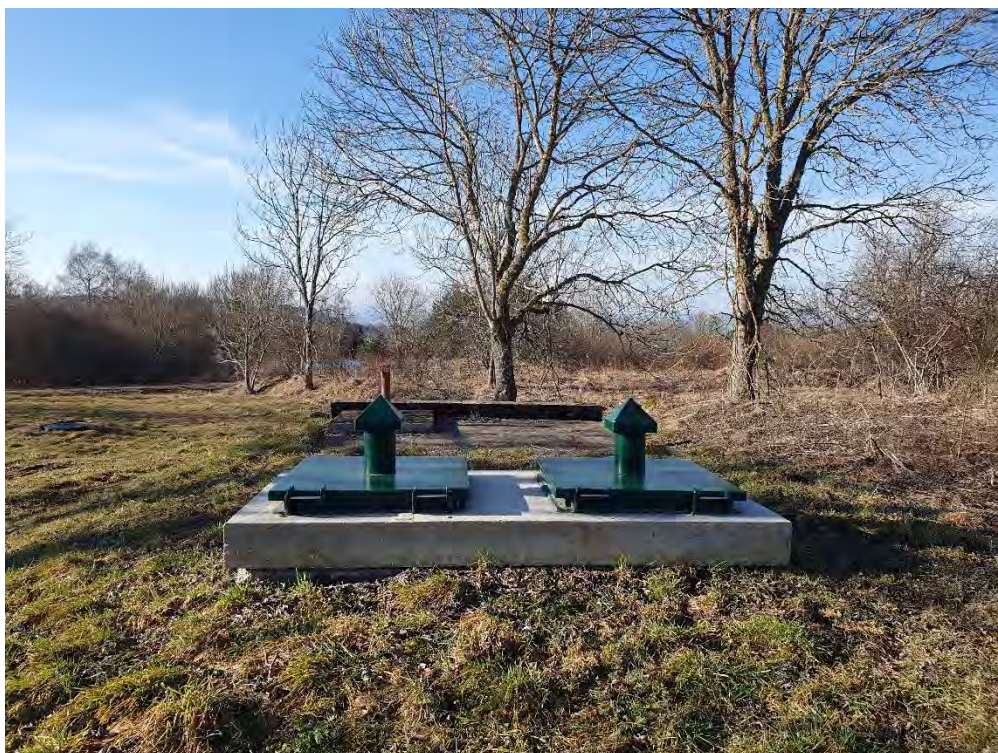
Figure 9 : Vue du réservoir d'eau potable sur la parcelle OA 838 (Source : MELVAN)
