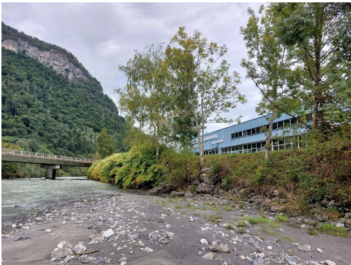
Figure 4 : Vues de la digue avec enrochements déstructurés au pied de l'usine Gradel Baudin
