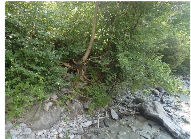
Cordon ligneux rivulaire dégradé sur enrochements
