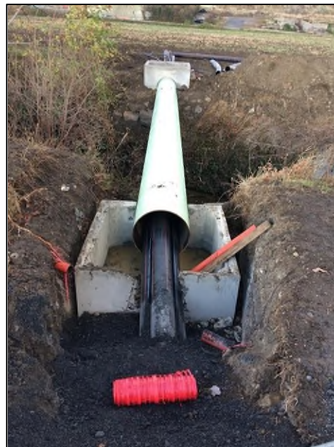
Figure 36 : Tube contenant les câbles (source : RTE)
