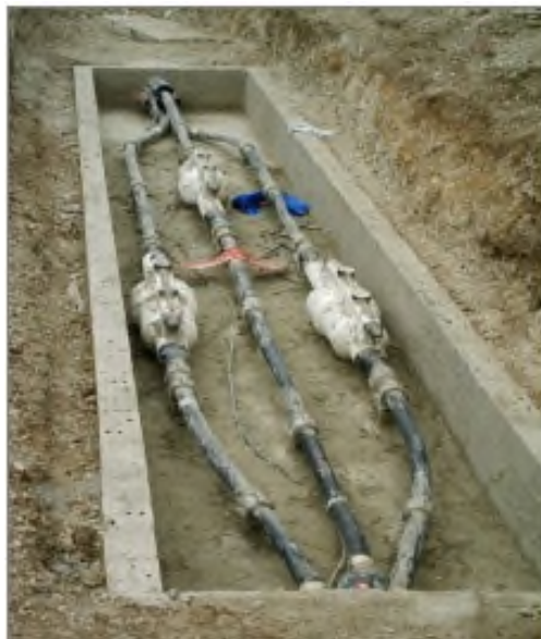
Figure 28 : Chambre de jonction (source : RTE)
