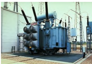
Figure 37 : Exemple d'une SELF barre de 95 MVAR
