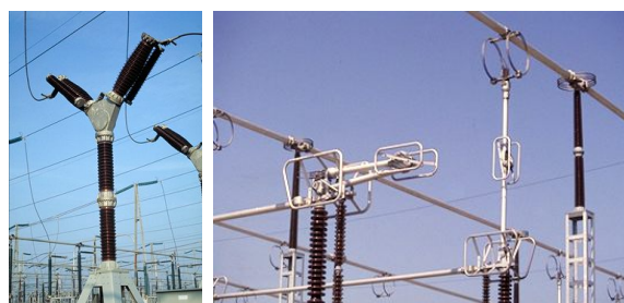
Figure 38 : Exemple d'un disjoncteur, d'un sectionneur et d'un jeu de barres
