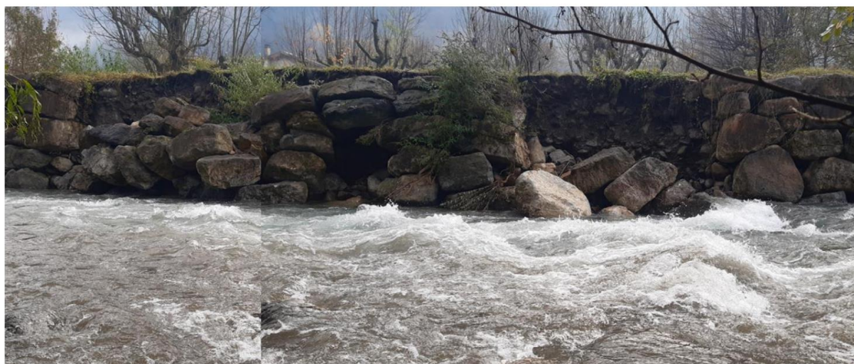
Figure 9 : Effondrement de l'enrochement observé sur la rive droite du Bréda. Vue depuis la rive opposée.
