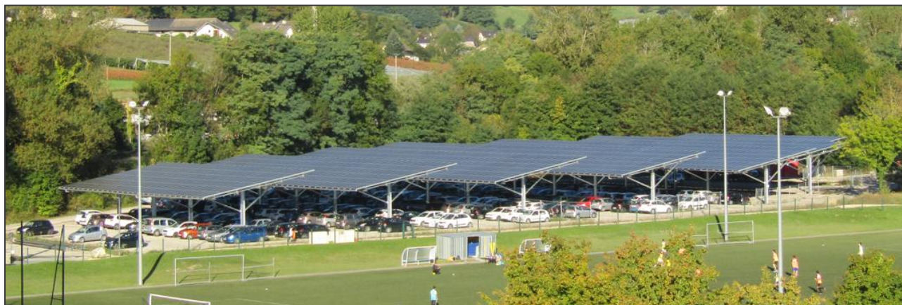
Figure 12 : photographie des ombrières installées sur la ZAC de Savoie Technolac
