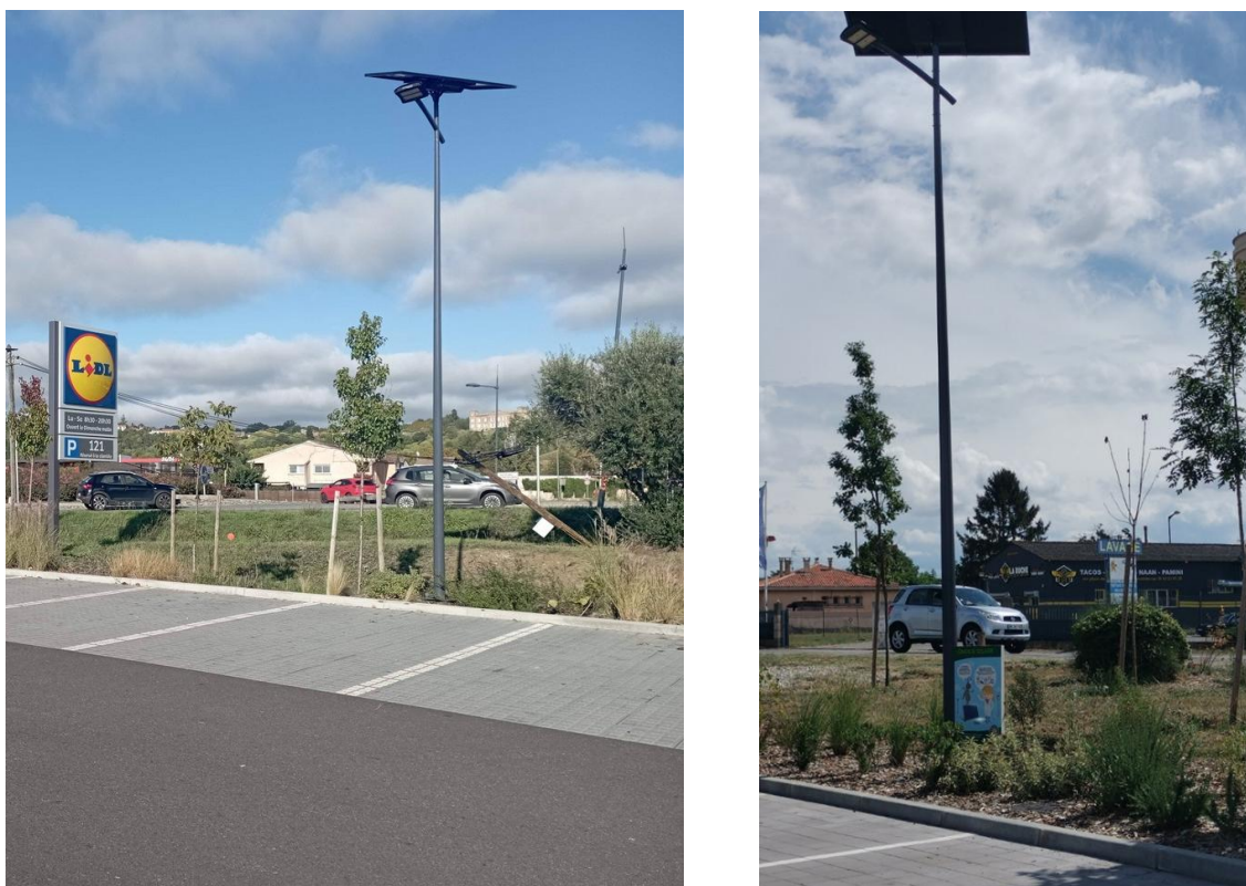
Figure 5 : Exemples d'éclairage par candélabres photovoltaïques sur des sites Lidl (Source : ADRET Nature, 2025)
