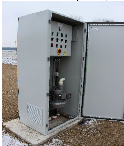
Ex de surpresseur nécessaire au fonctionnement des micro-STEP
