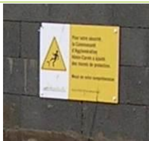
Figure 34 : Signalisation risque de chute
