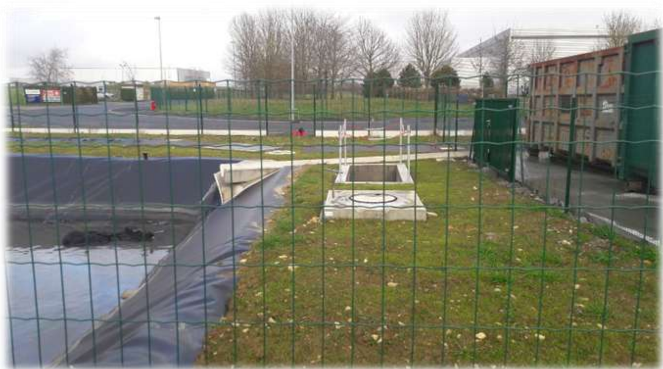
Photo 3 : Séparateur à hydrocarbure et décanteur
