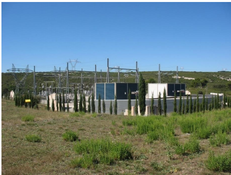
Figure 43 | Exemple du poste électrique 225 000 volts de la Duranne (commune d'Aix-en-Provence)
