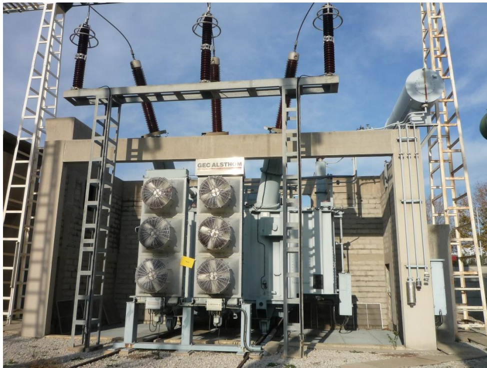
Figure 54 | Exemple de transformateur de tension primaire 225 000 Volts équipé de parois coupe-feu
