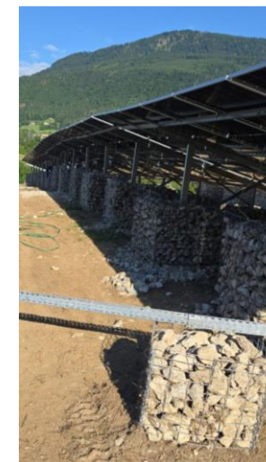
Exemple de chemin de câbles DC posé sur gabions (projet Enercoop – St Cergues (74) – 2025)
