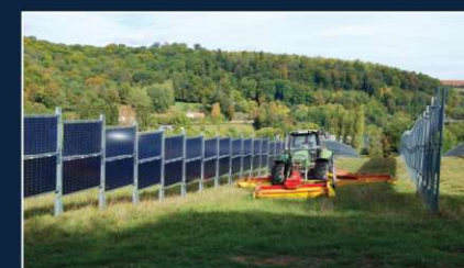
Les centrales équipées de panneaux verticaux
