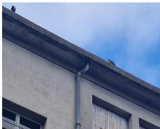
Fissure sur le bâtiment 3
