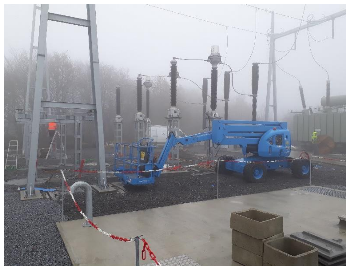
Illustration 13 : Mise en place des différents équipements HTB
