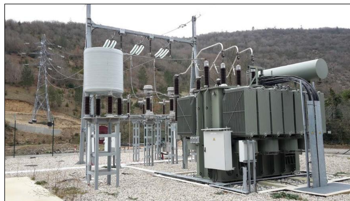
Illustration 7 : Poste électrique HTB
