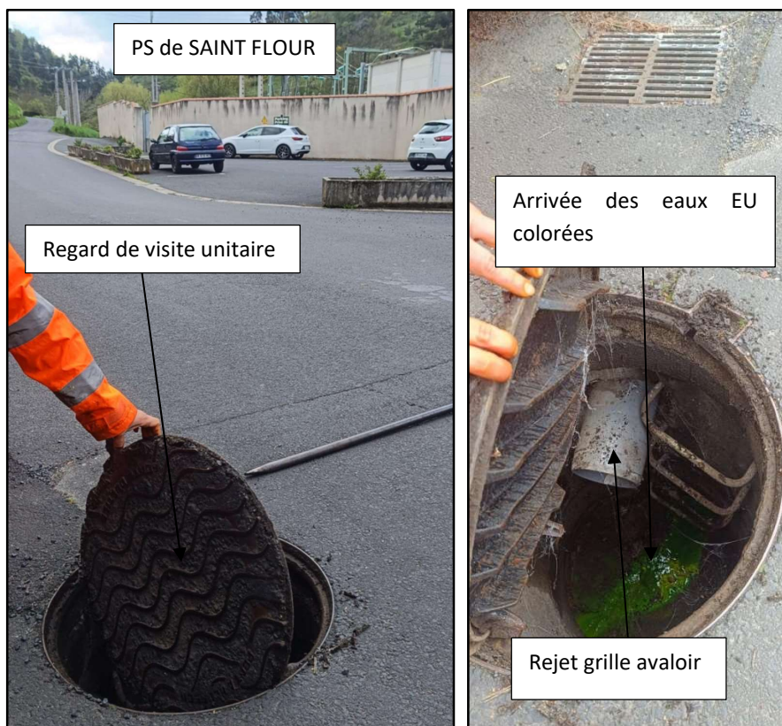
Figure 9 : Prises de vues des investigations sur le réseau EU (Source : ECR Environnement)
