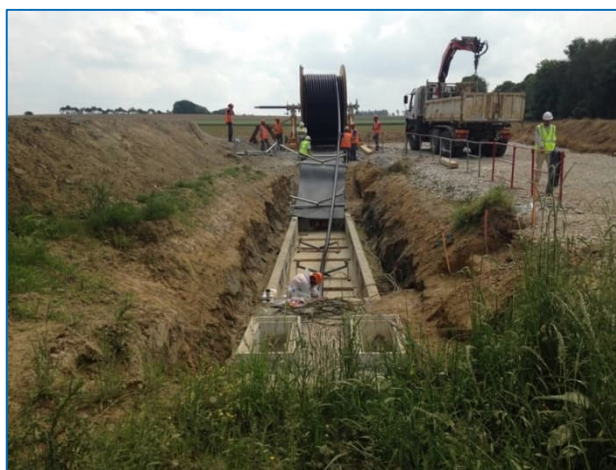
Figure 13 : Chambre jonction et puits de permutation au premier plan
