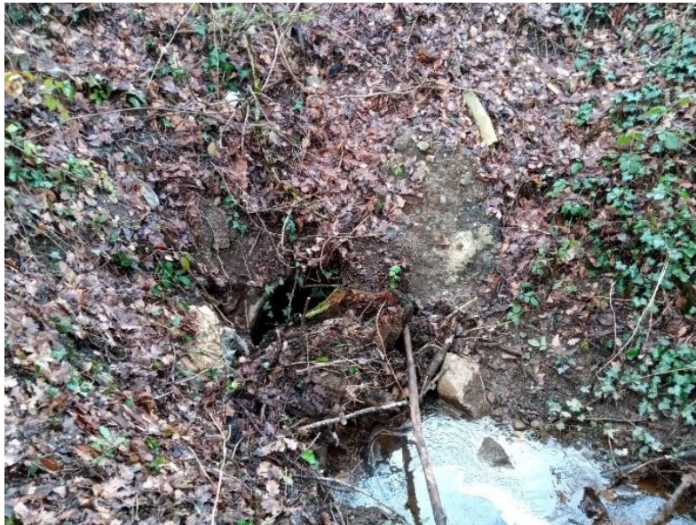
Figure 4 : Entonnement du tronçon TR-GR4 engravé et fermé par des embâcles
