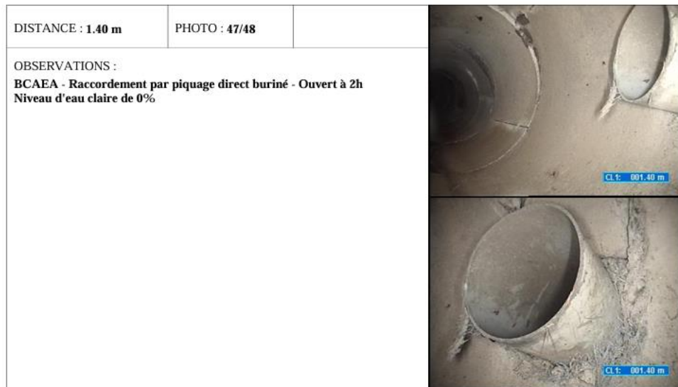
Figure 16 : Extrait du rapport de l'inspection robot du 25/08/2020
