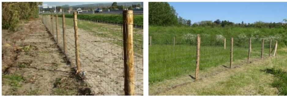
Figure 35 : Exemple d'une clôture de parc solaire – Source Melvan
