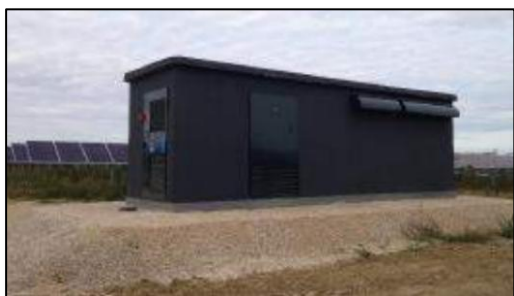
Figure 29 : Exemple de poste de transformation et de livraison
