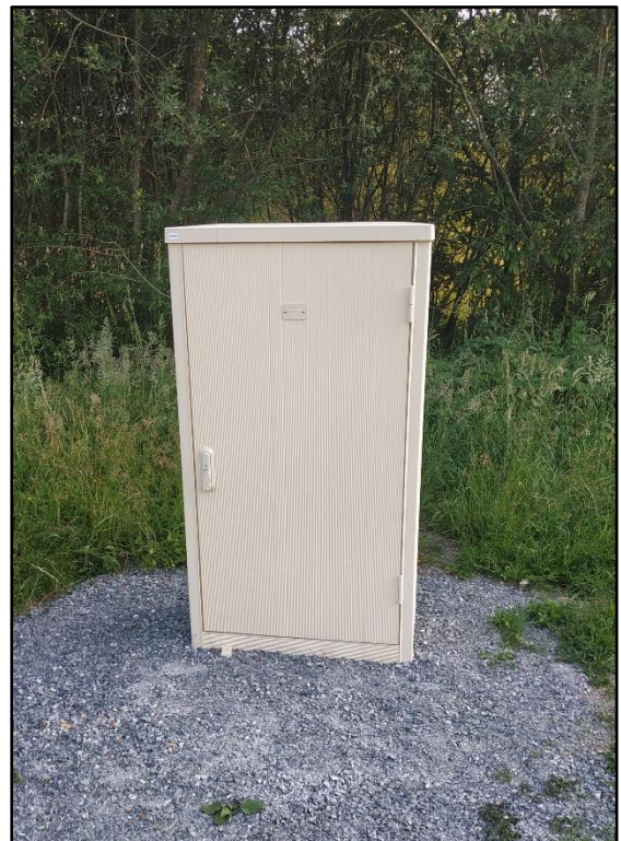
Photo 1 : Poste de livraison - Armoire tarif jaune
