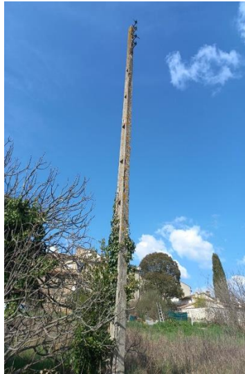
Photographie 13 : Poteau à l'Est du site hors service
