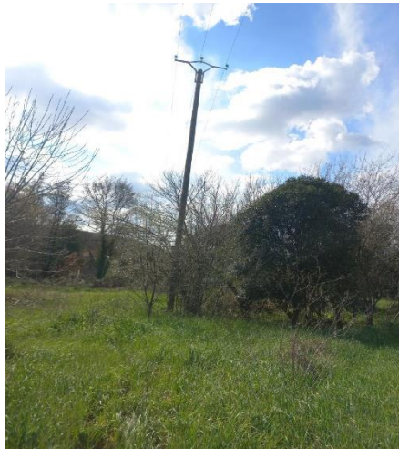
Photographie 15 : Poteau à l'Ouest du site avec ligne électrique en service
