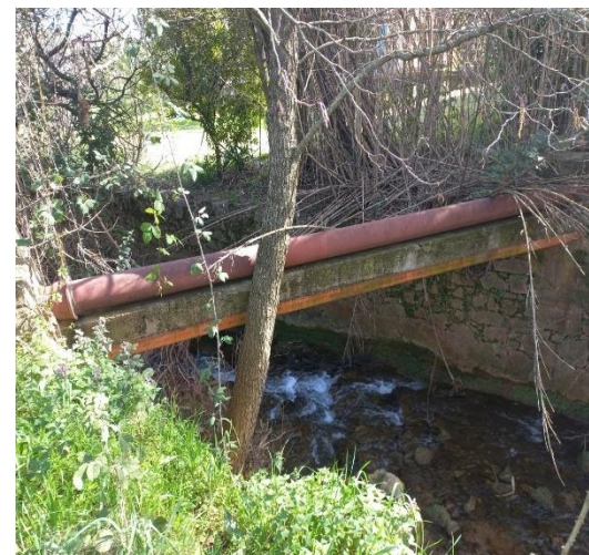
Photographie 10 : L'Aille avec canalisation du réseau d'eau traversant le cours d'eau
