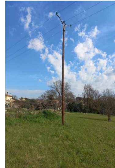
Photographie 14 : Poteau à l'Est du site avec ligne électrique en service
