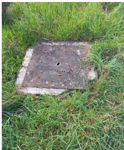
Photographie 9 : Réseau d'eau/assainissement au Sud du site
