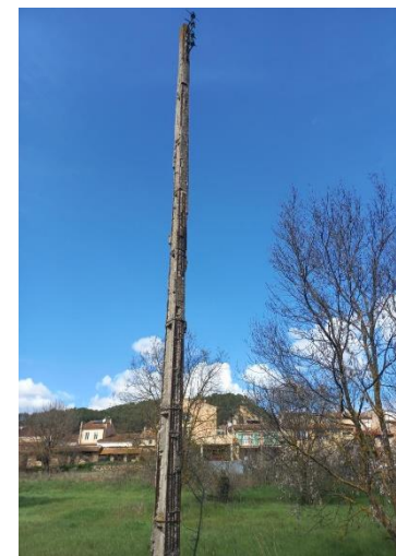
Photographie 12 : Poteau à l'Ouest du site hors service
