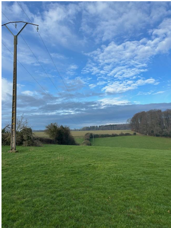
Ligne électrique : ZB7
