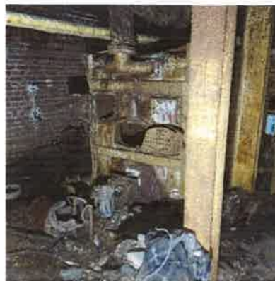
Photo 15 : Chaufferie au sous-sol
