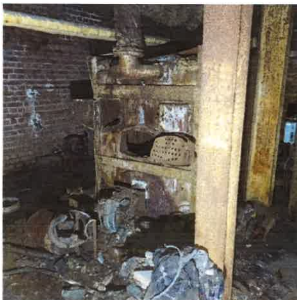
Photo 13 : Chaufferie au sous-sol
