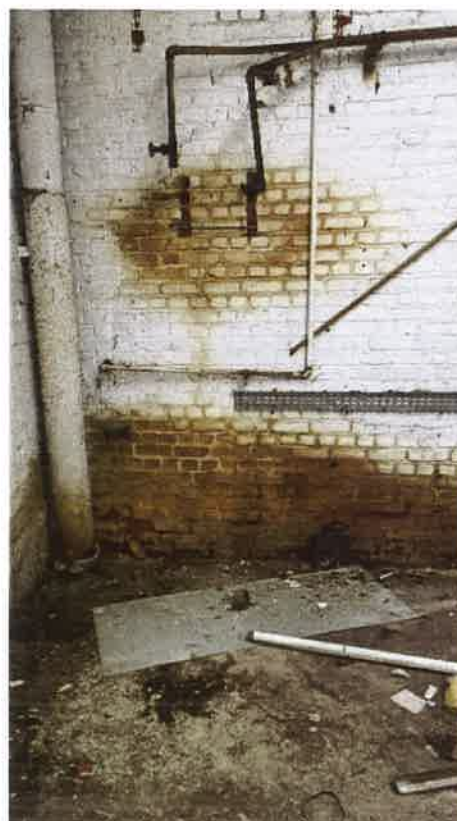
Photo 6 : Tâches sur le mur à la sortie des tuyaux provenant de la cuve
