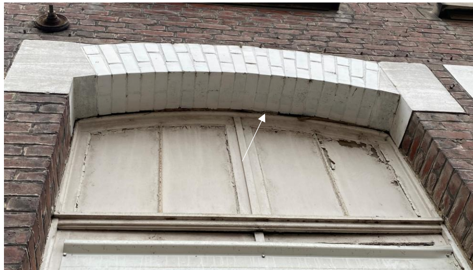
Fissures utilisables au-dessus de certaines fenêtres et des portes.
