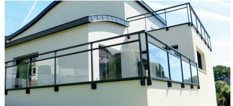
Garde-corps vitré : danger
