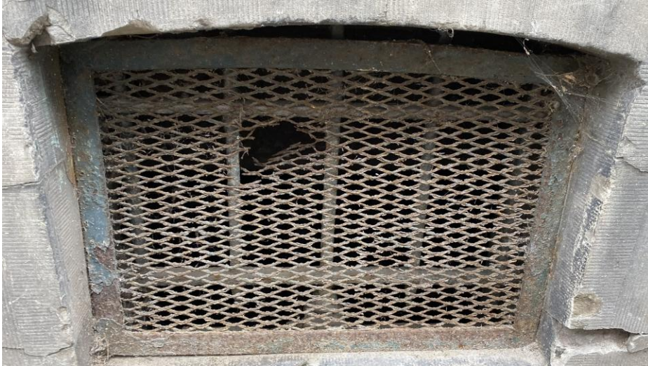
Défaut dans l'une des grilles permettant l'accès aux chiroptères
